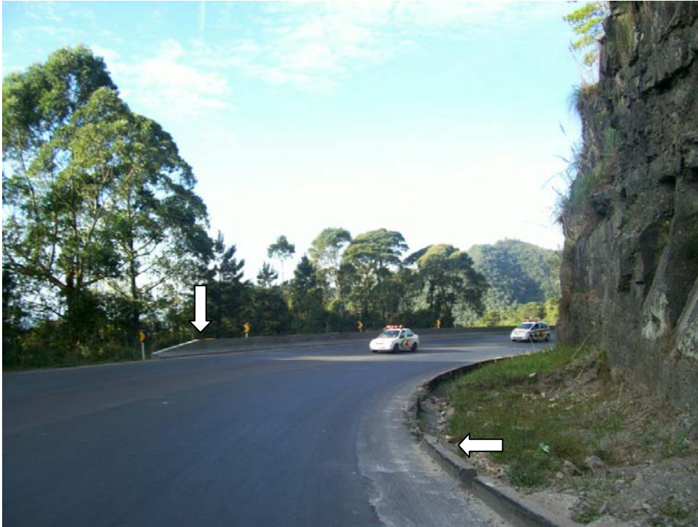
Figura 5 – Defesa ‘New Jersey’ e sinalização horizontal precária
