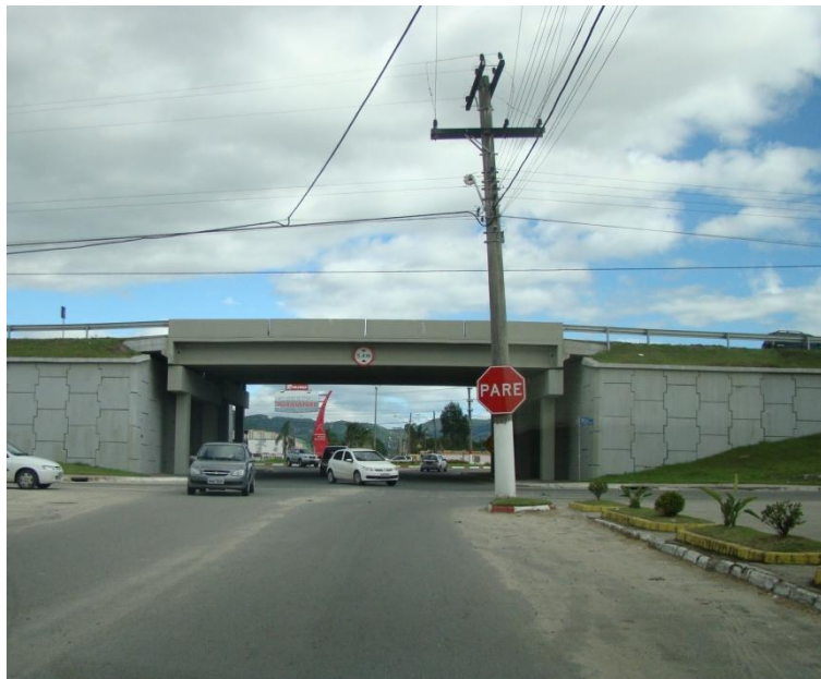
Figura 50 Poste localizado na pista de rolamento.
