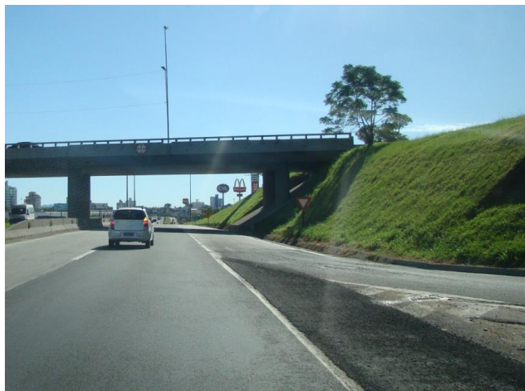
Figura 73 Ausência de marcas de canalização após serviços de manutenção no pavimento
