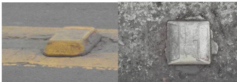
Figura 17 Sinalização horizontal sem conservação
