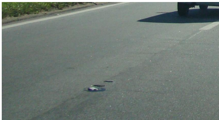
Figura 75 Tachas arrancadas do pavimento
