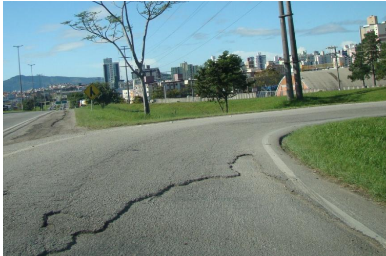
Figura 80 Defeitos no pavimento
