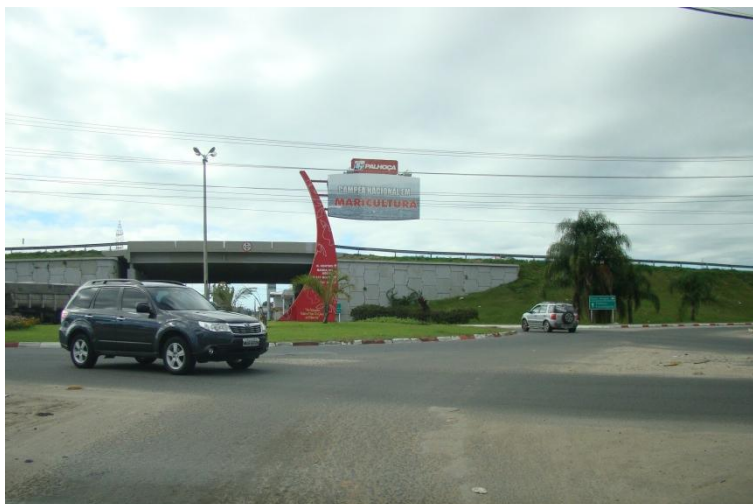
Figura 46 Material solto na interseção de Palhoça
