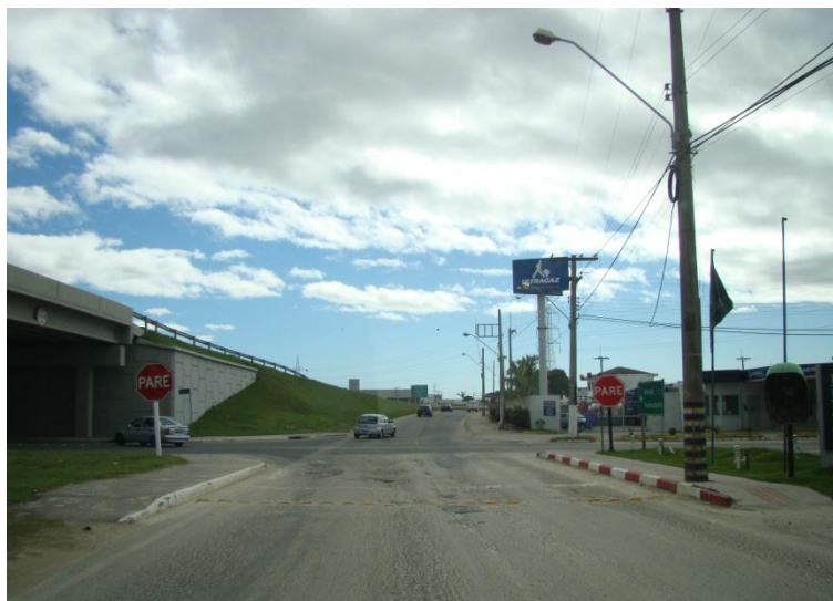
Figura 40 Desgaste das marcas longitudinais e transversais na via marginal da BR-101
