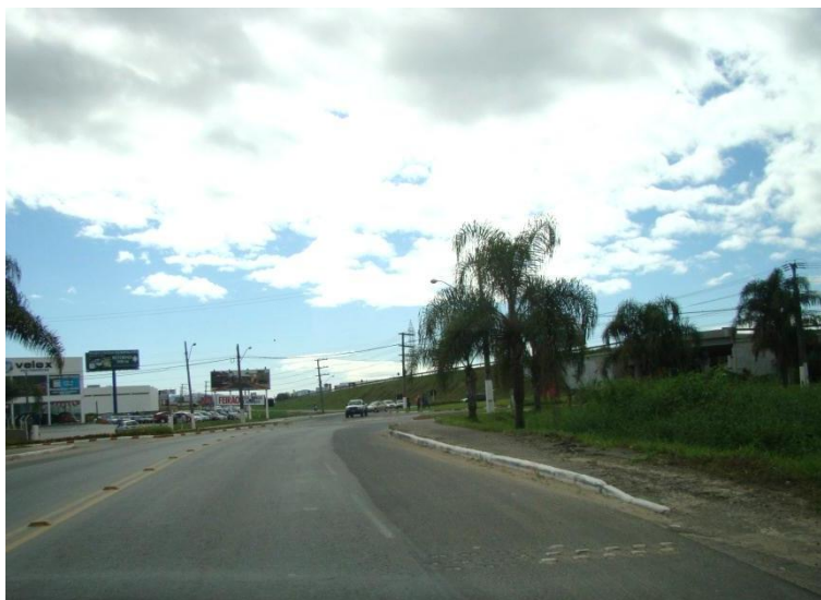
Figura 44 Desgaste da sinalização horizontal na aproximação da BR-282
