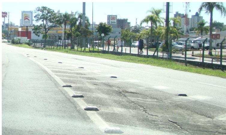
Figura 76 Ausência de tachões
