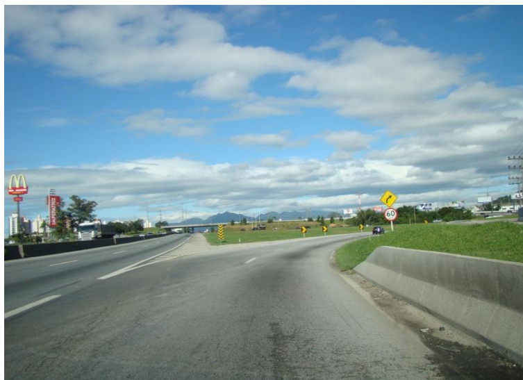
Figura 70 Desgaste na sinalização horizontal – Alça BR-101 à BR-282
