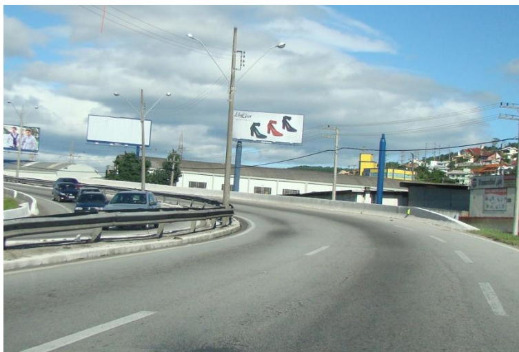
Figura 88 Ausência de dispositivos auxiliares nas defensas e na barreira de concreto
