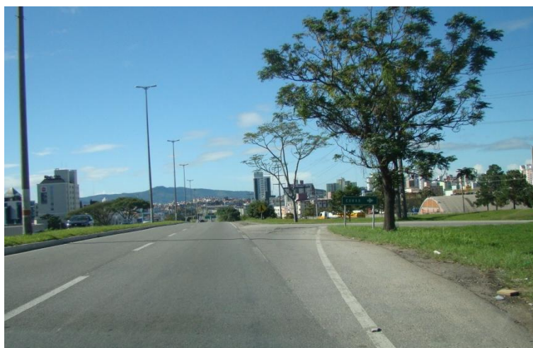
Figura 71 Desgaste na sinalização horizontal – Alça BR-282 à BR-101
