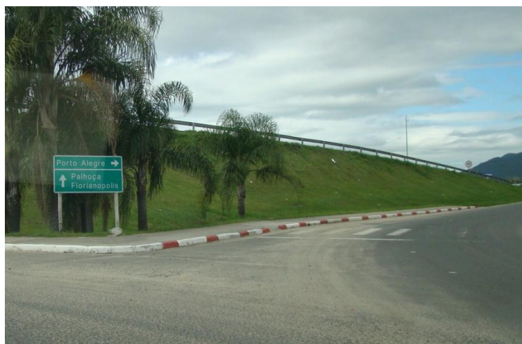
Figura 55 Desgaste na faixa de travessia de pedestres
