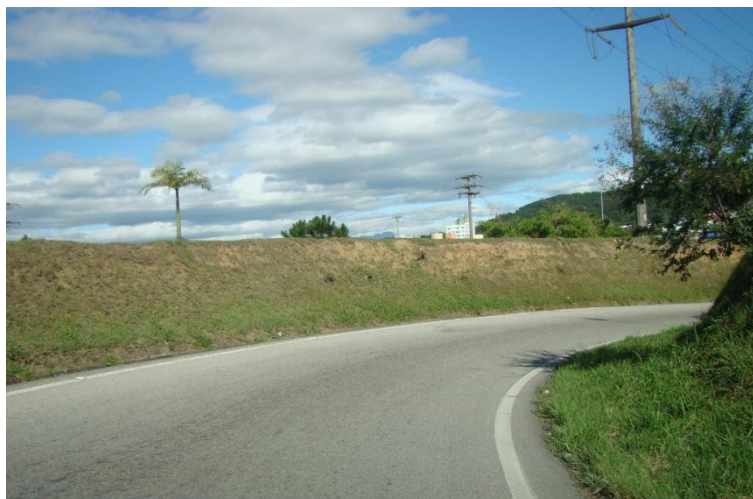
Figura 87 Ausência de marcadores de alinhamento
