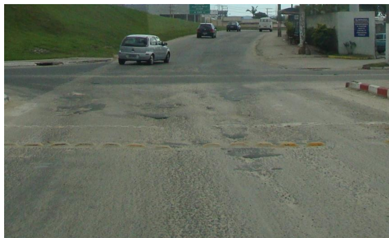
Figura 53 Defeitos diversos no pavimento da interseção de Palhoça
