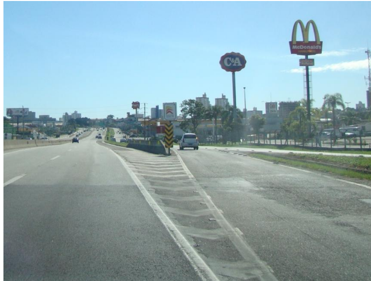
Figura 72 Desgaste das marcas de canalização
