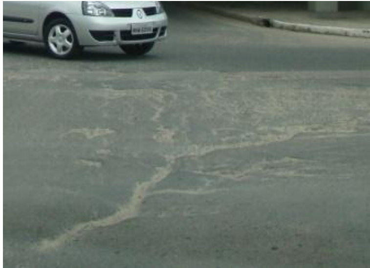
Figura 52 Trincas longitudinais no pavimento
