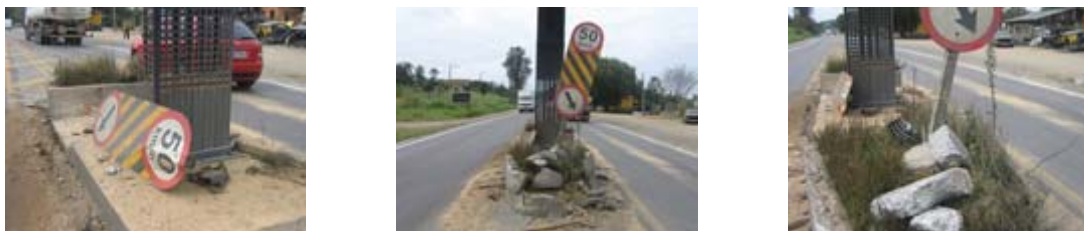
Figura 3 – Sinalização da BR 470 - KM 62 - Lombada quebrada – Março/2007
