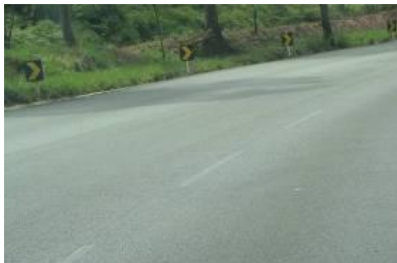
Figura 40. Sinalização horizontal desgastada
