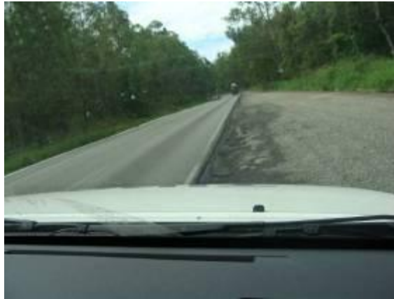
Figura 42. Desnível entre pista de rolamento e área de acostamento
