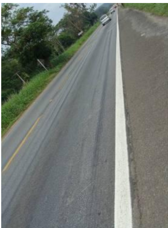
Figura 66. Marcas de frenagem na localização da ondulação
