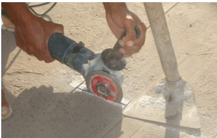
Figura 10 - Corte nas proximidades do sensor.
