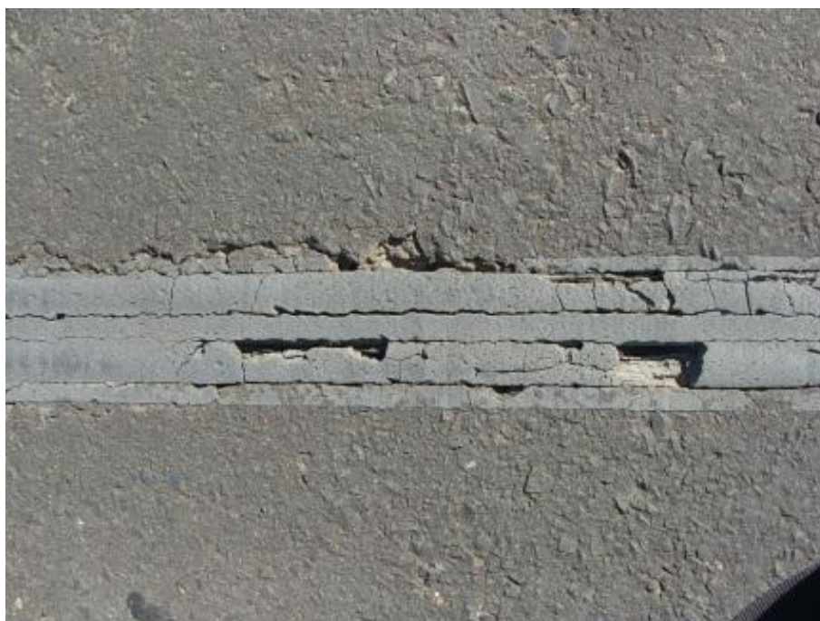
Figura 67 - Graute danificado do sensor cerâmico.
