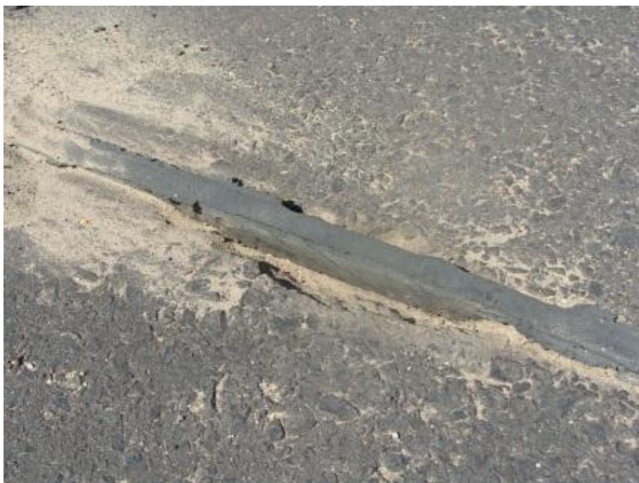
Figura 83 - Deterioração ao redor dos sensores óticos.
