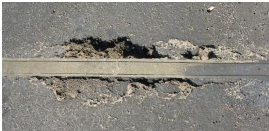
Figura 3 - Deterioração ao redor do sensor quartzo.
