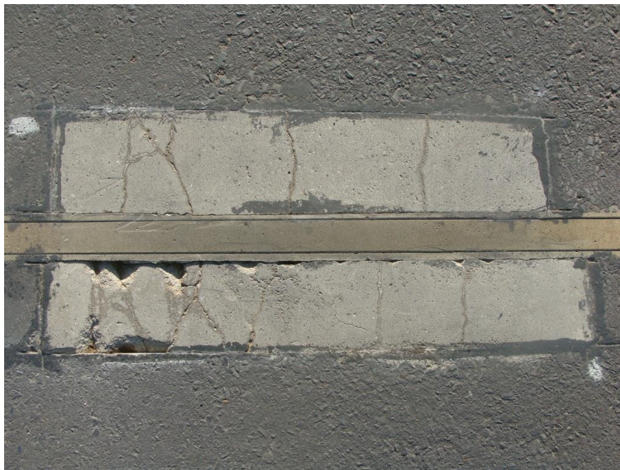
Figura 58 - Sensor 3Q16 danificado.
